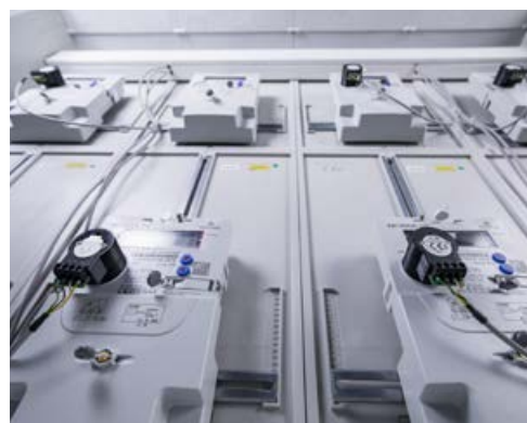
Zählerkasten mit installiertem Optokoppler im Keller der Siedlung an der Hosemannstraße in Berlin Prenzlauer Berg © ahnenenkel.com/Silke Reents
