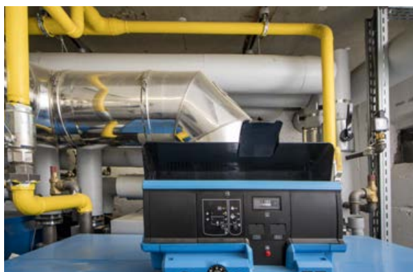
Blockheizkraftwerk im Keller der Siedlung an der Hosemannstraße in Berlin Prenzlauer Berg © ahnenenkel.com/Silke Reents
