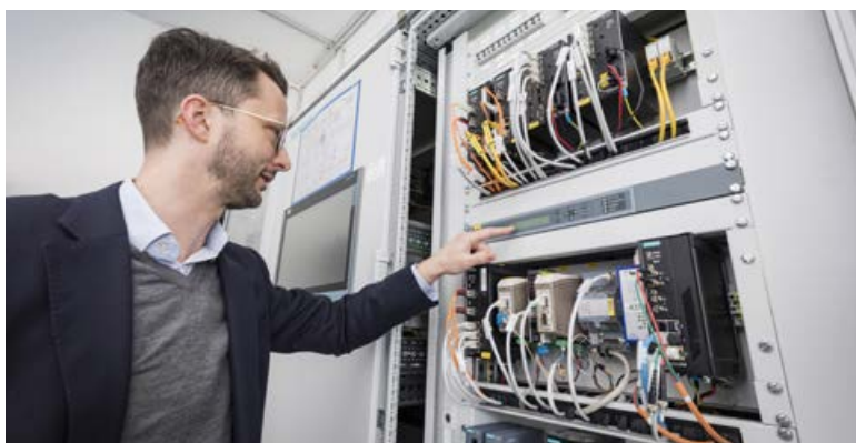
Friedrich Rojahn, CEO Solandeo, prüft die Montage der von Solandeo in den Schaltschränken des Batteriespeichers verbauten Smartmeter © ahnenenkel.com/Silke Reents
